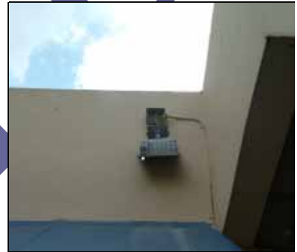
LÁMPARA FRENTE EDIFICIO
