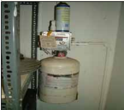
SISTEMA DE REGADERA EN CASO DE FUEGO
