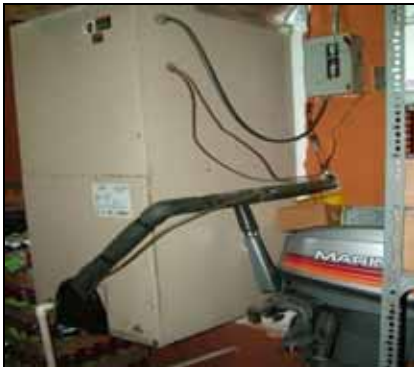
UNIDAD DE CAFETERÍA INSTALADA EN ALMACEN
