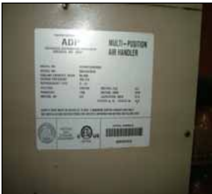
UNIDAD FUERA DE SERVICIO INSTALADA EN ALMACEN
