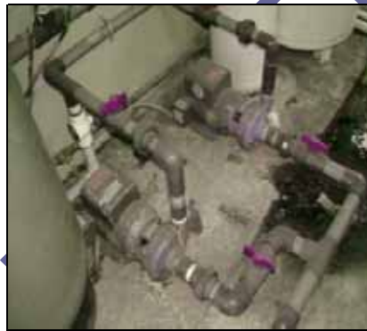
BOMBAS DE EXTRACCIÓN DE AGUA
