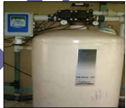
TANQUE DE ACONDICIONADOR DE AGUA
