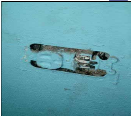
ÁREA DE CAJERA EN LAUNDRY POSIBLE CORTO CIRCUITO
