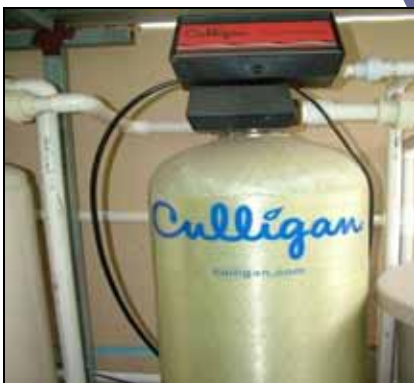
TANQUE DE ACONDICIONADOR DE AGUA
