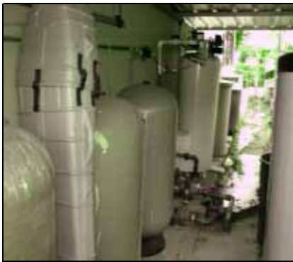
ÁREA BOMBAS DE EXTRACCIÓN DE AGUA Y TANQUES
