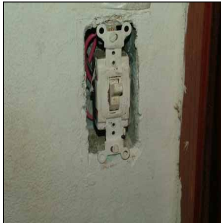
INTERRUPTOR ENTRADA BAÑO DAMAS - CAFETERIA
