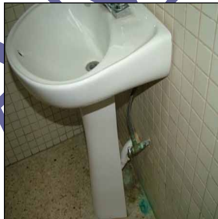
LAVAMANOS PEDESTAL BAÑO DAMAS - MUESTRA EN PISO DE QUE HA HABIDO SALIDA DE AGUA
