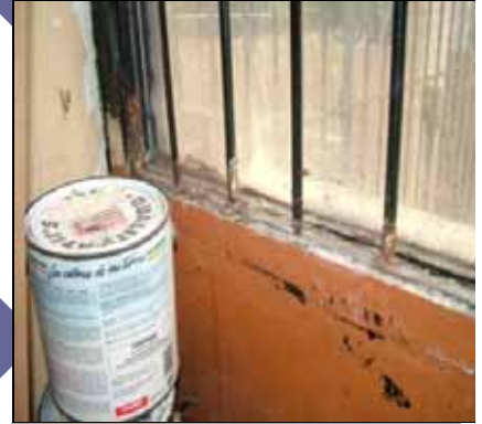
EVIDENCIA DE CORROSIÓN EN REJAS INTERIOR
