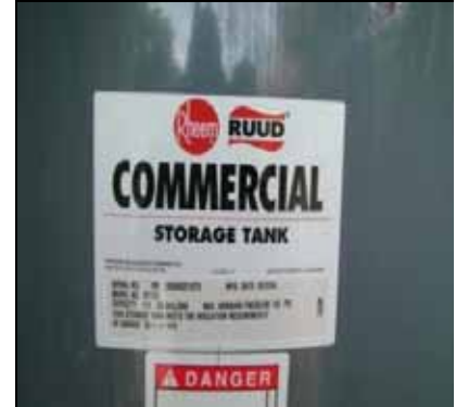
CALENTADOR DE TANQUE NO EN USO
