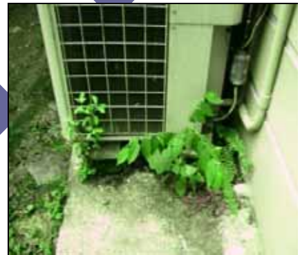
EVIDENCIA HUMEDAD EN ÁREA Y LÍNEA REPARADA
