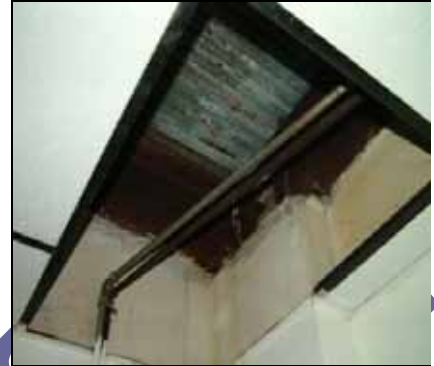
FALTA LOZA DE TECHO
