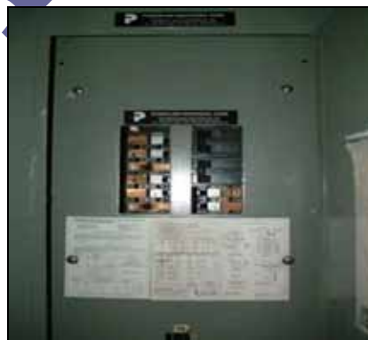
SUBPANEL #3 AREA DE LAUNDRY (CERCA BAÑO)
