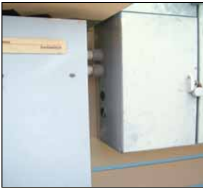
EXTERIOR ÁREA CONTADORES ACCESOS SIN SELLAR
