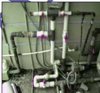
SISTEMA DE TUBERÍA DE AGUA EXTRAÍDA DEL POZO
