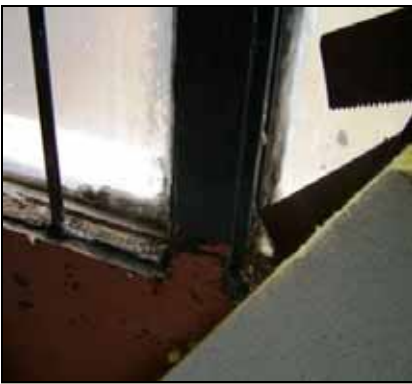
EVIDENCIA DE CORROSIÓN EN REJAS INTERIOR
