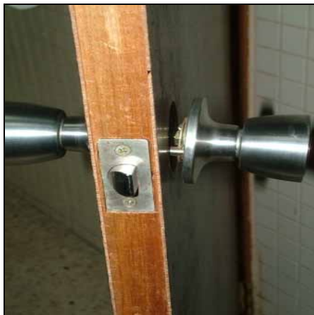
CAERRADURA PUERTA INTERIOR BAÑO DAMAS
