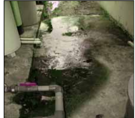
DESCARGA DE AGUA EN ÁREA DE CEMENTO - CREANDO LIMO
