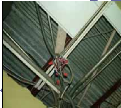
AREA DE LAUNDRY - SUBPANELES #3 Y #4
