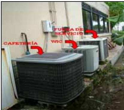
IDENTIFICACIÓN UNIDADES EN EXTERIOR
