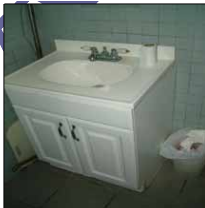
MUEBLE LAVAMANOS Y LAVAMANOS BAÑO LAUNDRY
