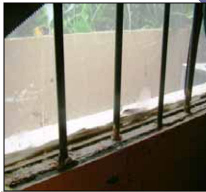
EVIDENCIA DE CORROSIÓN EN REJAS INTERIOR
