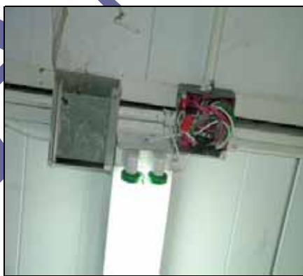
ÁREA DE LAUNDRY - FALTA TAPA CIEGA 4X4
