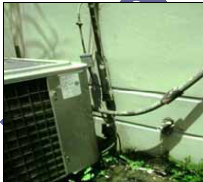
COMPRESOR CAFETERIA Y DESAGUE QUE CON LIMO
