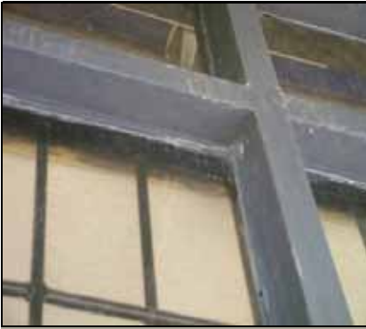
ESTADO DE CRISTALES EN LA ESTRUCTURA
