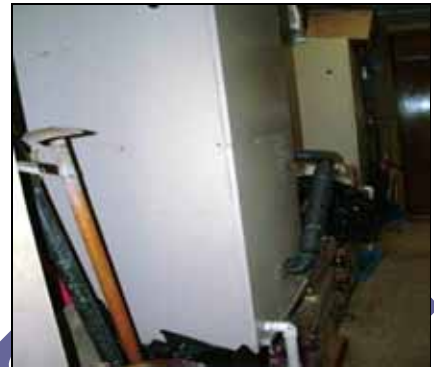
UNIDAD FUERA DE SERVICIO INSTALADA EN ALMACEN
