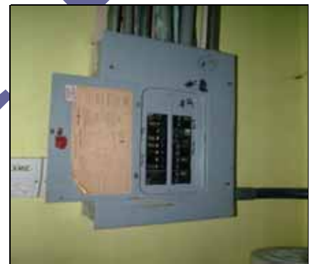
SUBPANEL #3 AREA DE LAUNDRY (CERCA BAÑO)
