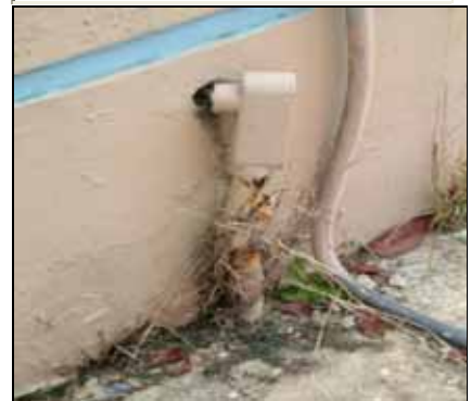
TUBO ELÉCTRICO PARTIDO Y FUERA PARED - CONTADORES
